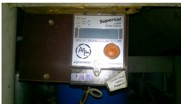
Rys.6 – Istniejący licznik energii cieplnej
