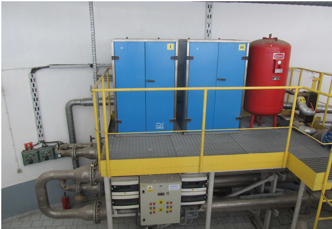
Rys.1 – Istniejące pompy ciepła na terenie OŚ
