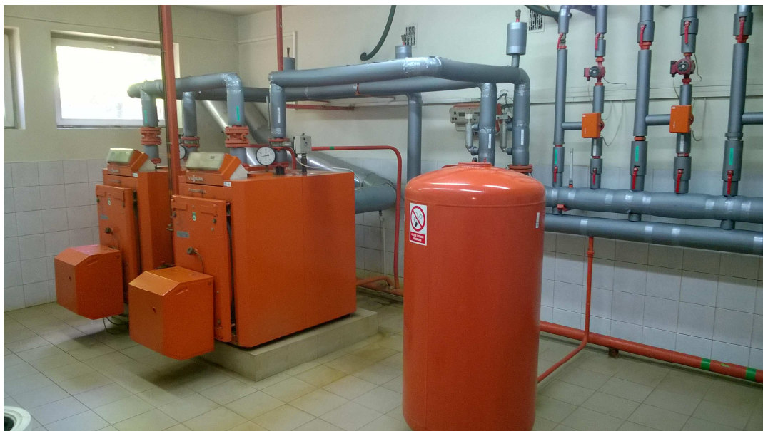
Rys.2 – Pomieszczenie kotłowni na terenie SUW
